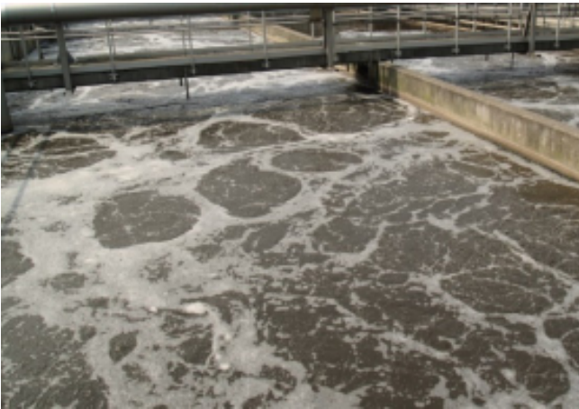
REACTOR BIOLÓGICO DE BARROS ACTIVADOS SISTEMA EN OPERACIÓN
