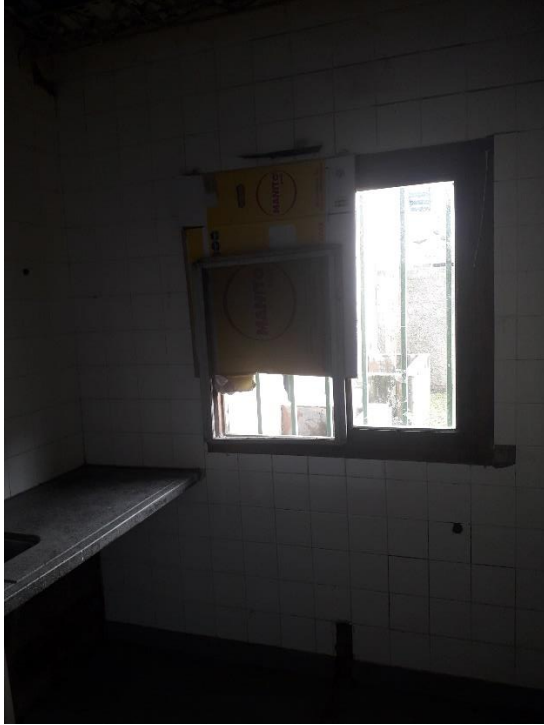
Ventana a cambiar por nueva
